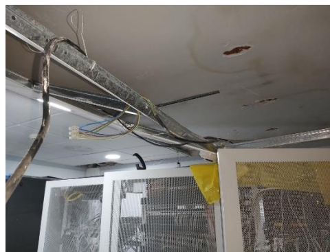
Ilustración 4 Techo sala servidores
